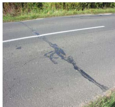
Obr. 35 Pohľad na mrazovú trhlinu a jej opis podľa TP 083 [116]
