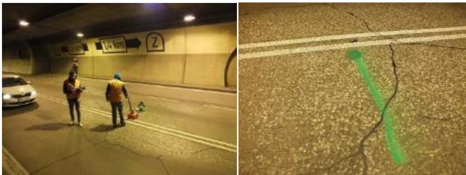
Obr. 34 Pohľady na trhliny CB vozovky tunela [115]
